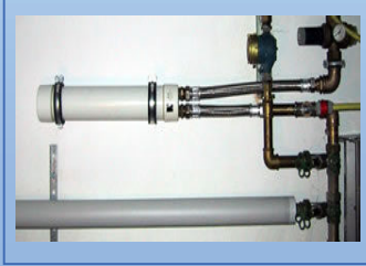
Zentraler Haus-Wasser- Anschluss nach der Wasseruhr
